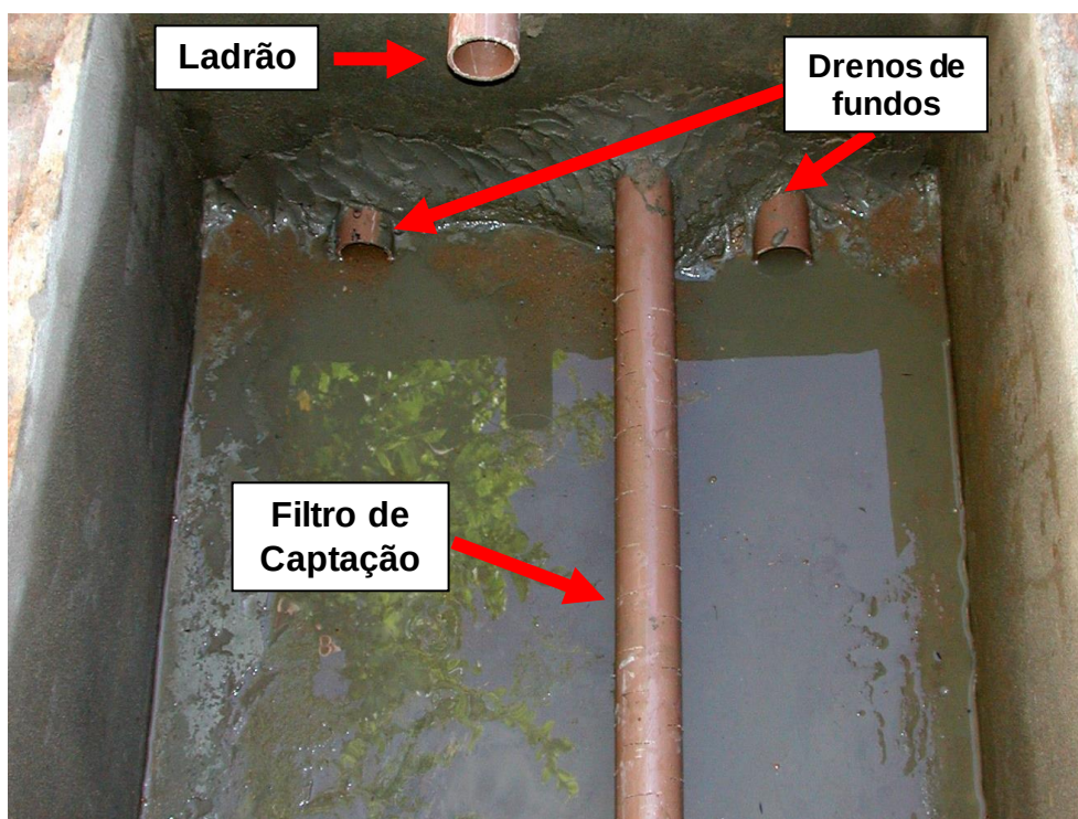
Figura 9 - Drenos de fundo, ladrão e filtro de captação na área interna.
