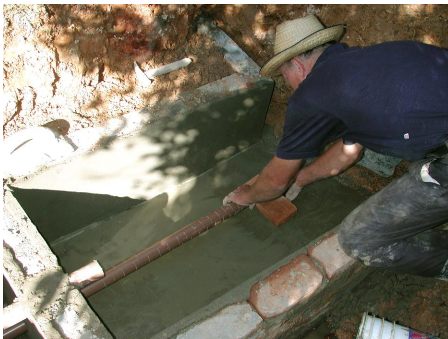
Figura 6 - Filtro de captação.
