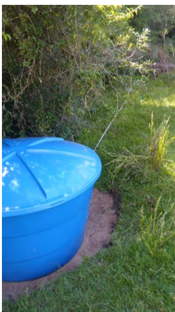
Figura 16 – Caixa d'água colocada a jusante da fonte.
